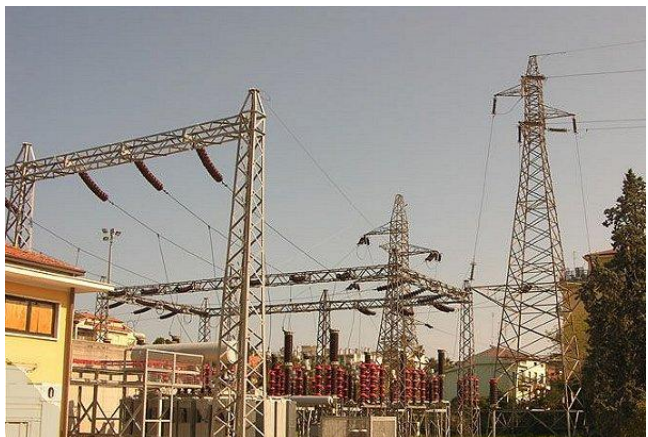
Una sottostazione elettrica ferroviaria con relativi tralicci.
